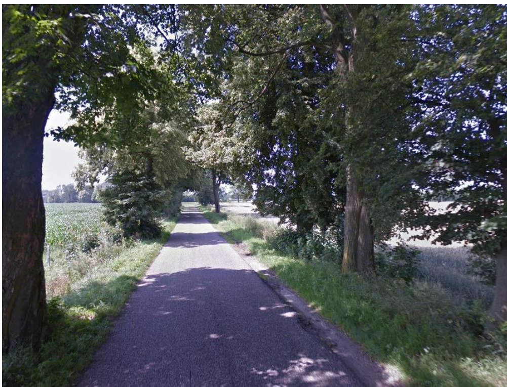
Centralno – zachodnia część planowanej do przebudowy drogi, widok w kierunku zachodnim – zniszczona nawierzchnia oraz wyeksploatowane pobocze.
