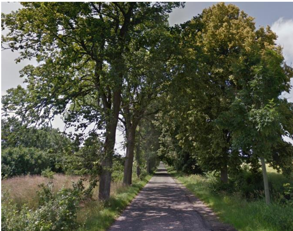
Wschodnia część planowanej do przebudowy drogi, widok w kierunku zachodnim – zniszczona nawierzchnia oraz wyeksploatowane pobocze.
