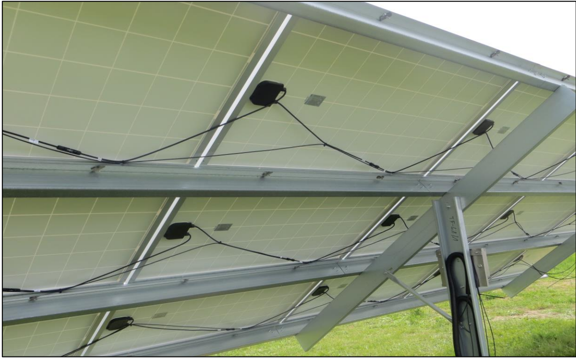
Fot. 6. Połączenia kablowe pomiędzy panelami fotowoltaicznymi
